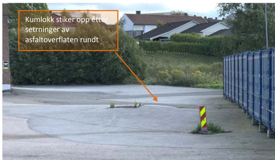
Bilde 5: Oppstikkende kumlokk indikerer store setninger på asfaltert plass
