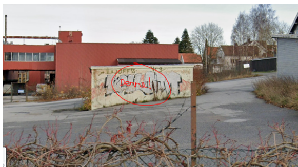
Figur 44 Dagens offentlige nettstasjon/trafo innenfor planområdet.
