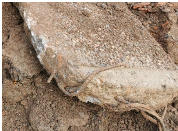
Figur 72: Betong i punkt 10
