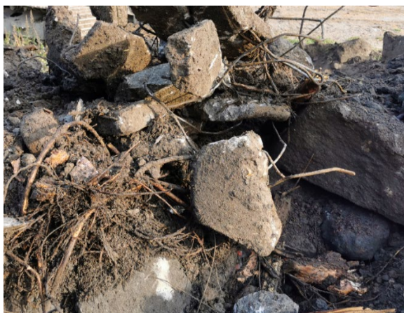
Figur 31: Røtter og betong m/armeringsjern
