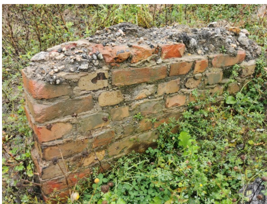
Figur 76: Teglsteinvegg med mørtel i punkt 3
