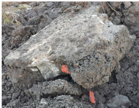
Figur 44 Betong i punkt 4
