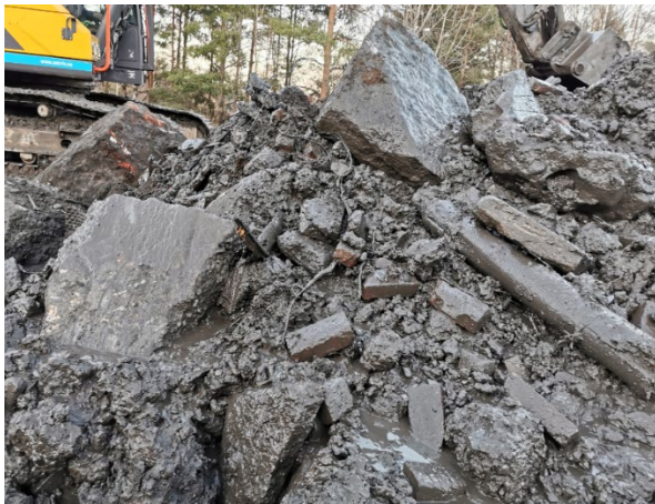
Figur 56 Pukk, blokker, vann, tegl og stolper i massene.
