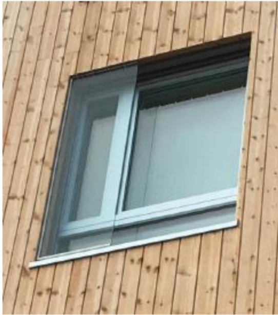
Figur 9 - Eksempel på skjermet luftvindu. Bilde hentet fra "Gardemovegen 29-31 Utendørs støyutredning for rammesøknad", Brekke og Strand.
