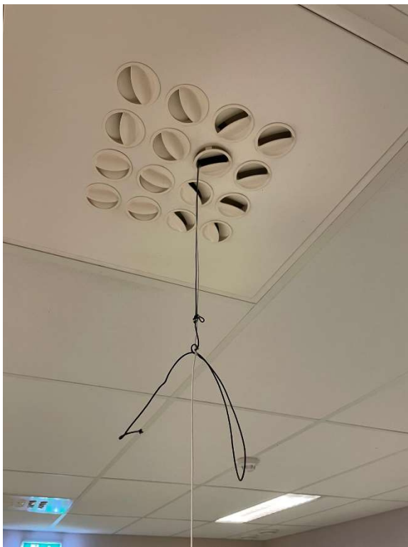
35 Luftbehandling. Fjern tråd ifra tilluftsluke i klasserom.
