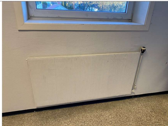
32 Varme. Gamle radiatorer.
