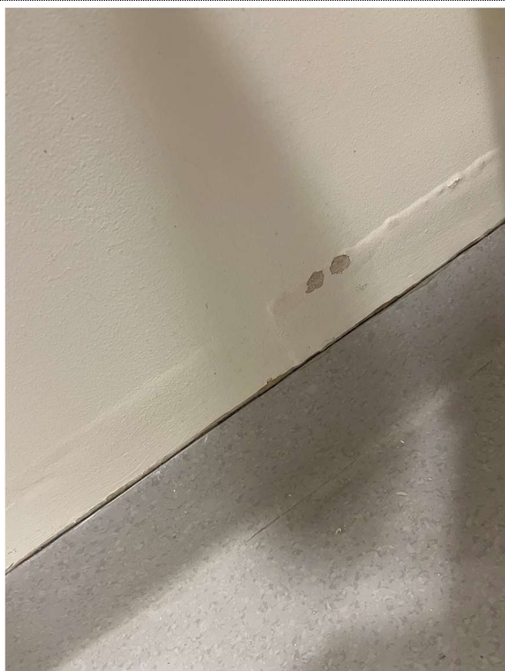
24 Innervegger. Eksempler på skader på malingen i garderoben.
