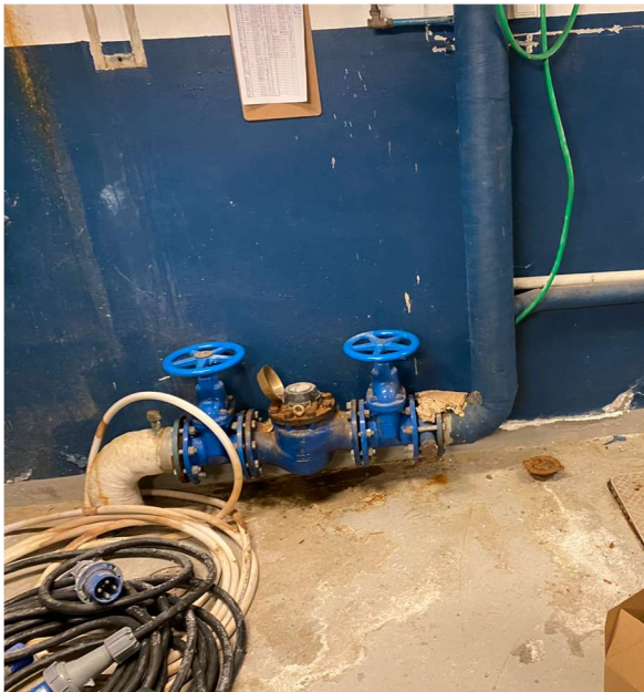
32 Varme. Teknisk rom i kjelleren på bygg A.
