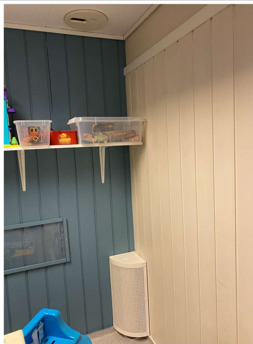
36 Luftbehandling. Kald tilluftventil.
