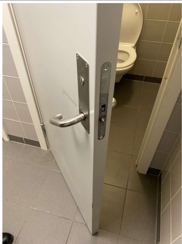
24 Innervegger. Dørhåndtaket er skadet på grunn av hærverk.
