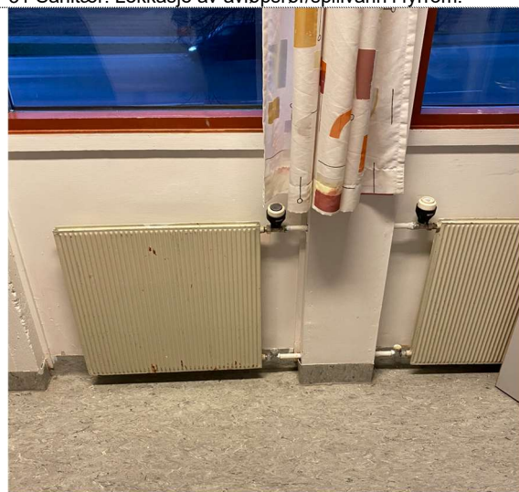
32 Varme. Gamle radiatorer.
