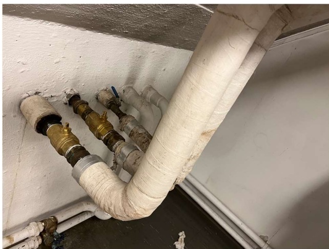
31 Sanitær. Usikkert hvor avstengt vann har gått!
