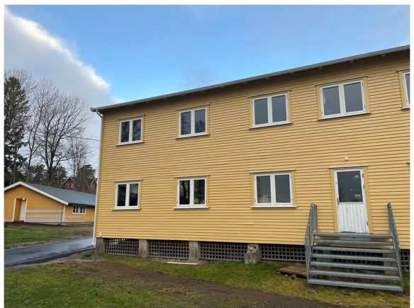
23 Yttervegger. Ytterdøren mot sjøen må byttes.
