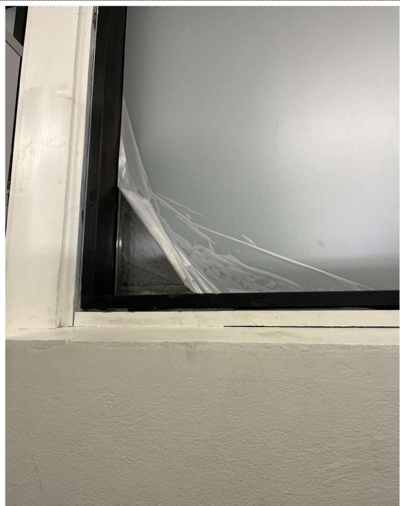
23 Yttervegger. Solfilmen begynner å revne.
