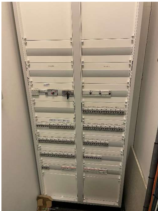
43 Lavspent forsyning. Fjern brennbart materiale i rom.
