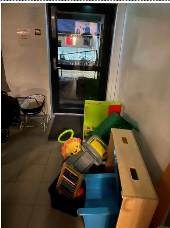
23 Yttervegger. Fjern løse gjenstander foran rømningsvei.
