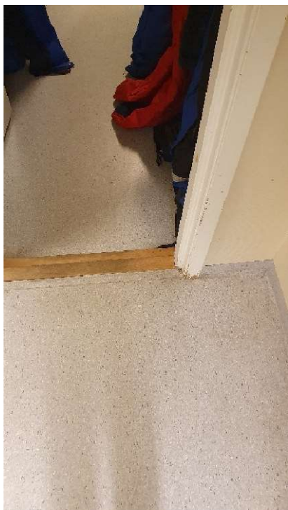
24 Innervegger. Overflater er slitte.
