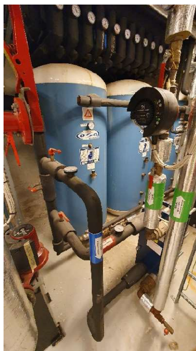
31 Sanitær. Vannberedere som trolig har overskredet levealder.
