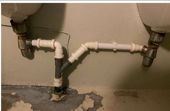
31 Sanitær. Rør må byttes før det oppstår lekkasjer.
