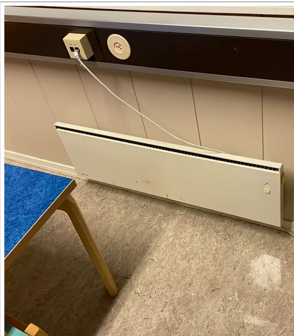
45 Elvarme. Elektrisk varmeovn avgir for høy temperatur.
