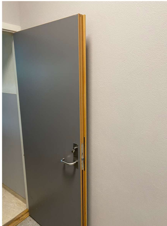
24 Innervegger. Dør mangler gummlist.
