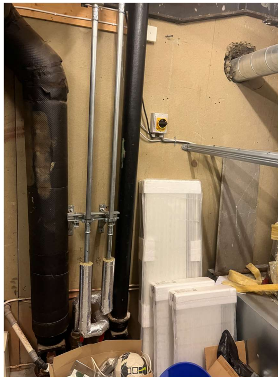
36 Luftbehandling. Ventilasjonssystem i bygget fra XXX
