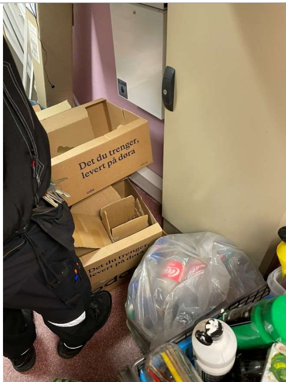
43 Lavspent forsyning. Fjern løse gjenstander ved EL-skap.
