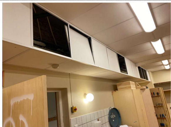
25 Dekker. Det er skadet himlingplater i kunst- og håndverksrommet.
