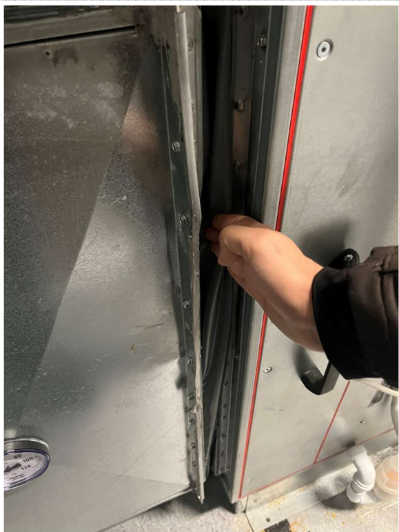
36 Luftbehandling. Luftlekkasjer i ventilasjonsanlegget.
