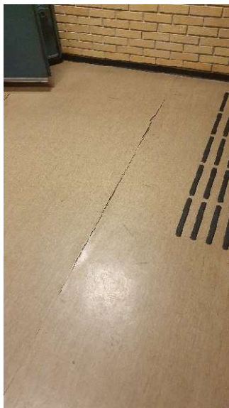
23 Yttervegg, vannskadet belegg ved trapp
