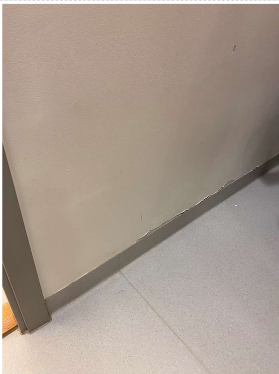
24 Innervegger. Eksempler på skader på belegg og malingen i garderoben.
