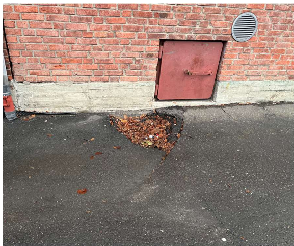
72 Utendørs konstruksjoner. Lav luke til tilfluktsrom, trenger en oppkant for å hindre vanninntrenging i bygget.
