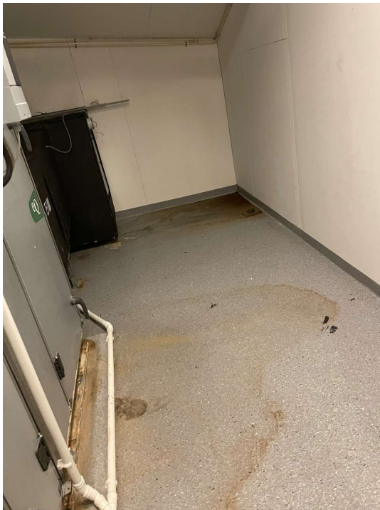
25 Dekker. Ventilasjonsrom har feil fall på dekke.
