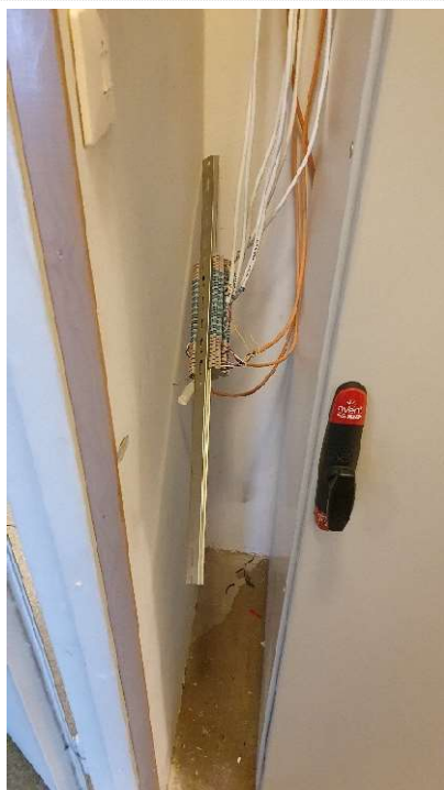
43 Lavspent forsyning. Løse deler på tavlerom.
