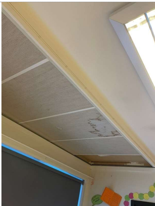
25 Dekker. Vann/fuktskade på himling. Bytt ut himling.
