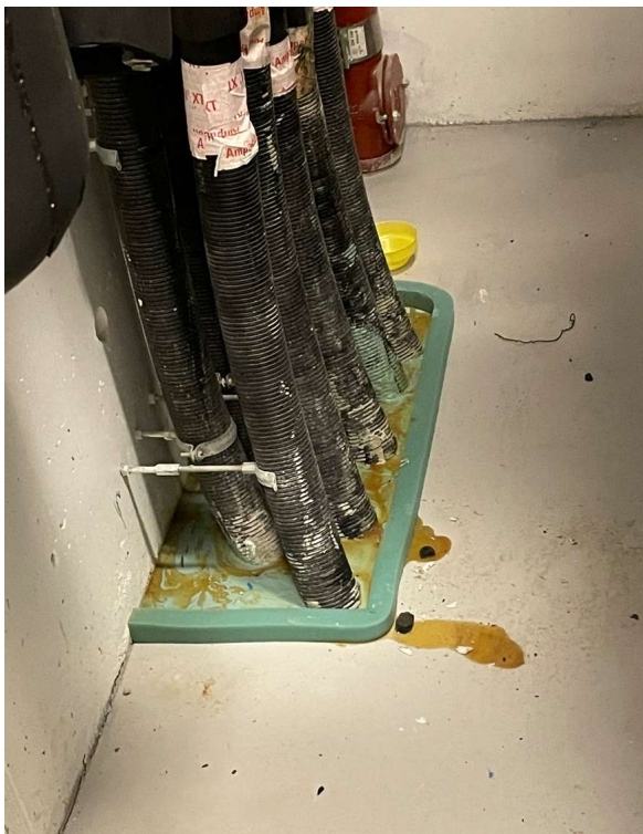
35 Varmepumpe- og kuldeinstallasjoner. Rengjør og kartlegg eventuelle lekkasjer.
