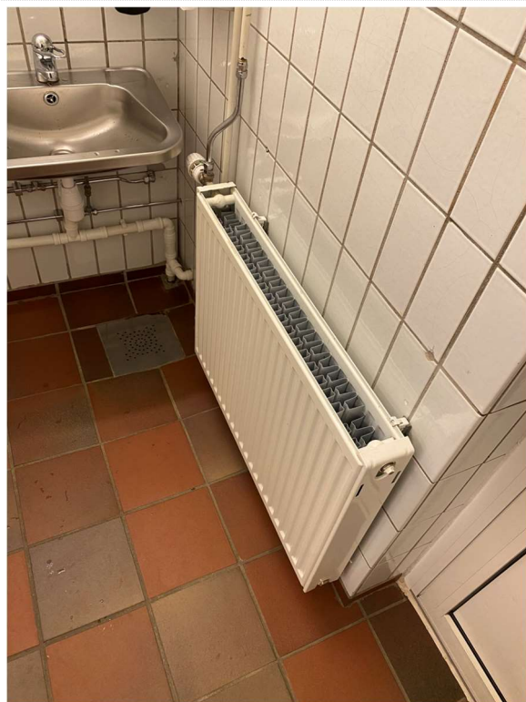
32 Varme. Skadet radiator.
