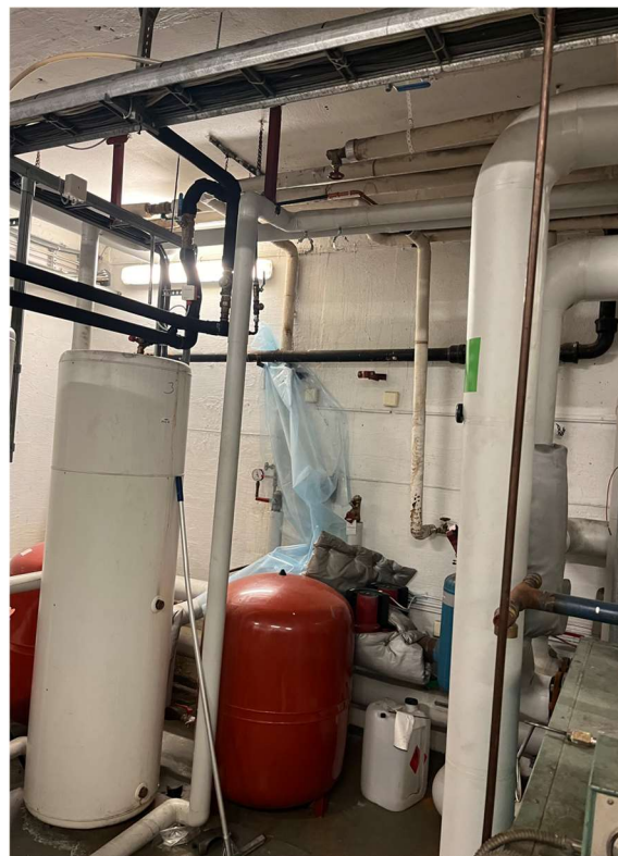
31 Sanitær. Lekkasje av avløpsrør/spillvann i fyrrom.
