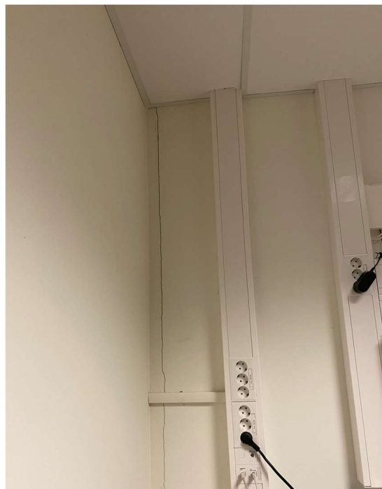
24 Innervegger. Eksempler på sprekk og riss på innerveggene i bygget.
