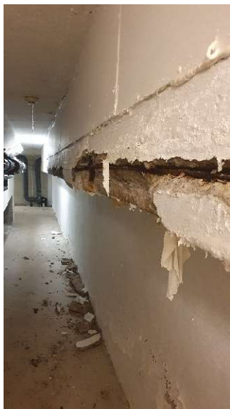
24 Innervegger, konsoll med synlig armering
