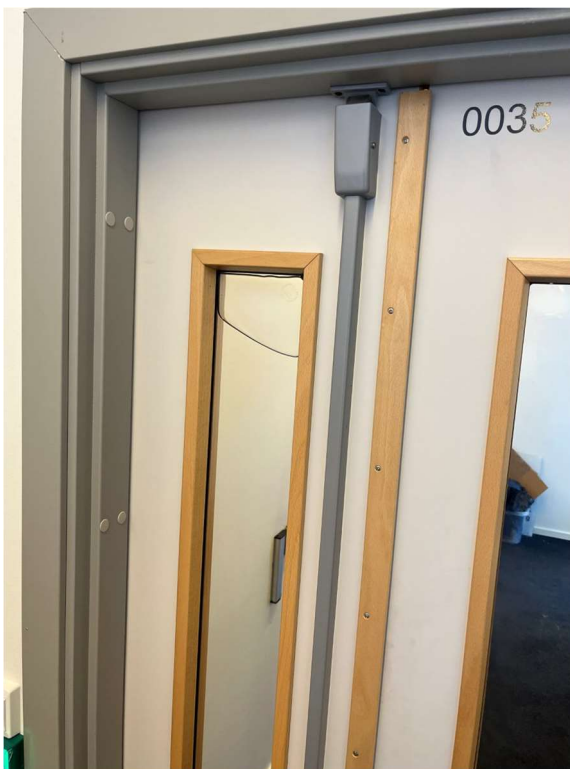
24 Innervegger. Sprekk i glasset på dør 0035.
