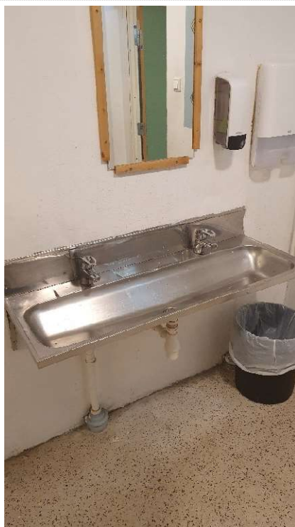
31 Ledningsnett er trolig fra byggeår.
