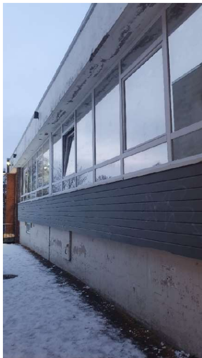
25 Dekker. Dekke med korroderende armering
