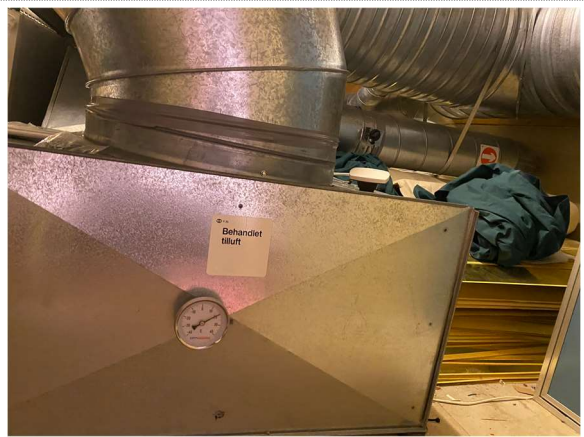
36 Luftbehandling. Behandlet tilluft 18 grader.
