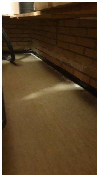
23 Yttervegg, vannskade vegg (bøttekott)
