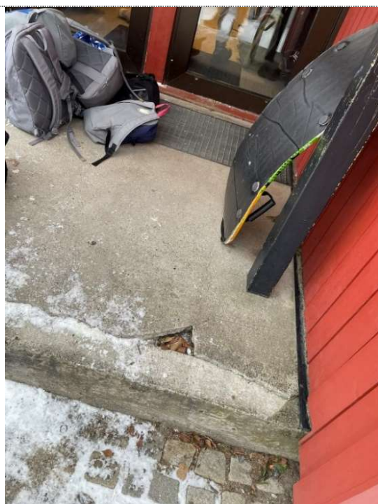
28 Trapper, balkonger m.m. Tette hull og avskallede elementer på inngangstrapper.
