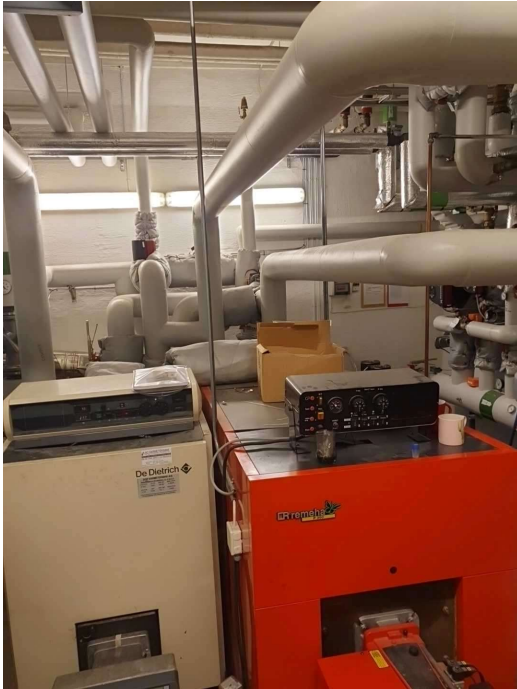
32 Varmeanlegg. Gammel oljefyr må fjernes.
