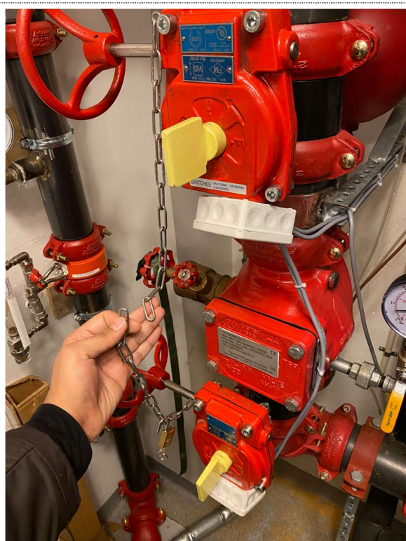
33 Brannslukking. Åpen kjetting av sprinkleranlegget.
