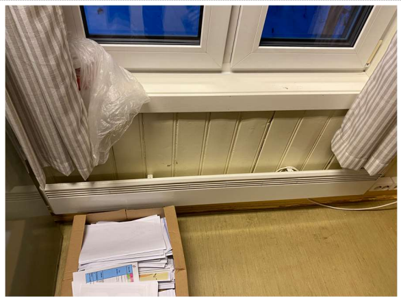
45 Elvarme. Papiresken ligger for nært elvarmen.
