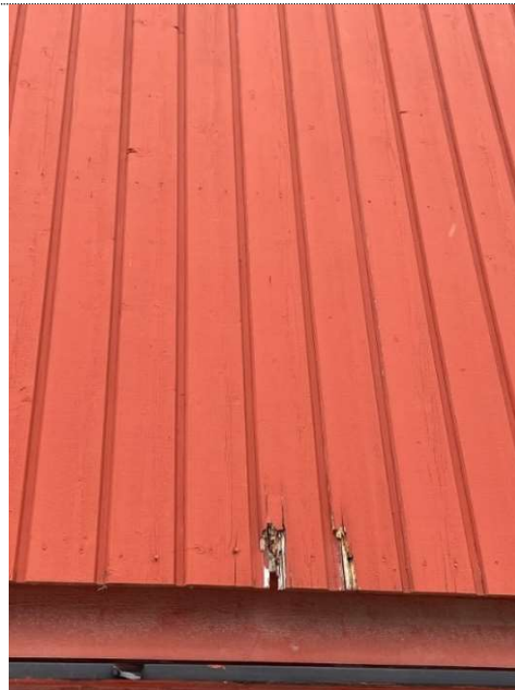
23 Yttervegger. Fuktskade i ytterkledning noen steder.
