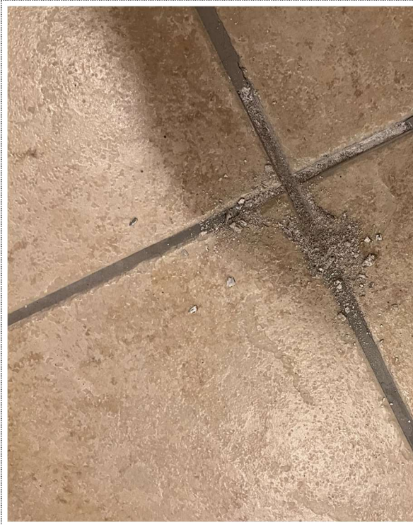
25 Dekker. Løsnet flisefuge i kantinerommet i kjelleren.
