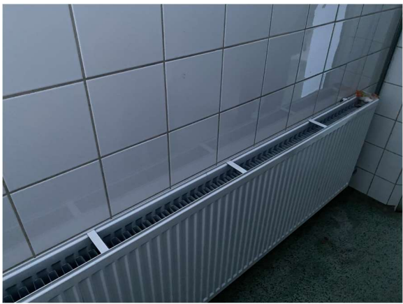
32 Varme. Skadet radiatorer.
