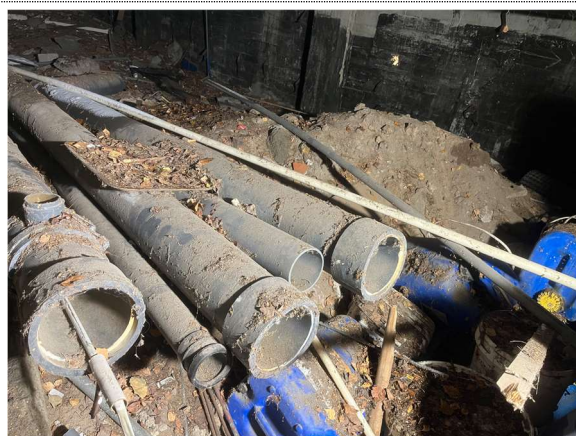
65 Avfall og støvsuging. Avfall under ett av byggene på skolen.
