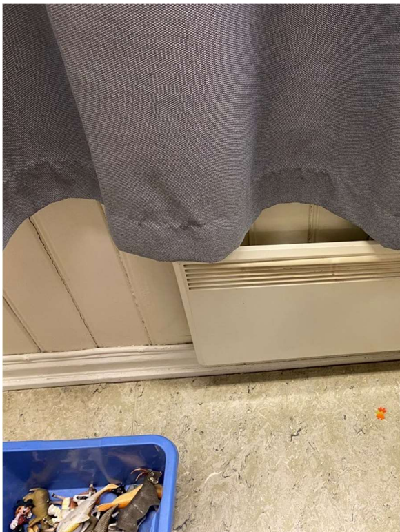
45 Elvarme. Elektrisk varmeovn med svært høy temperatur.
