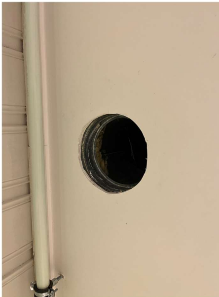
36 Luftbehandling. Ventilasjonsrøret på himling i første etasje mangler deksel.
