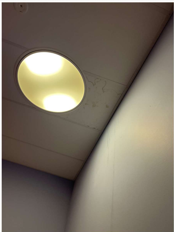
26 Yttertak. Skadet himling forårsaket av lekkasje.
