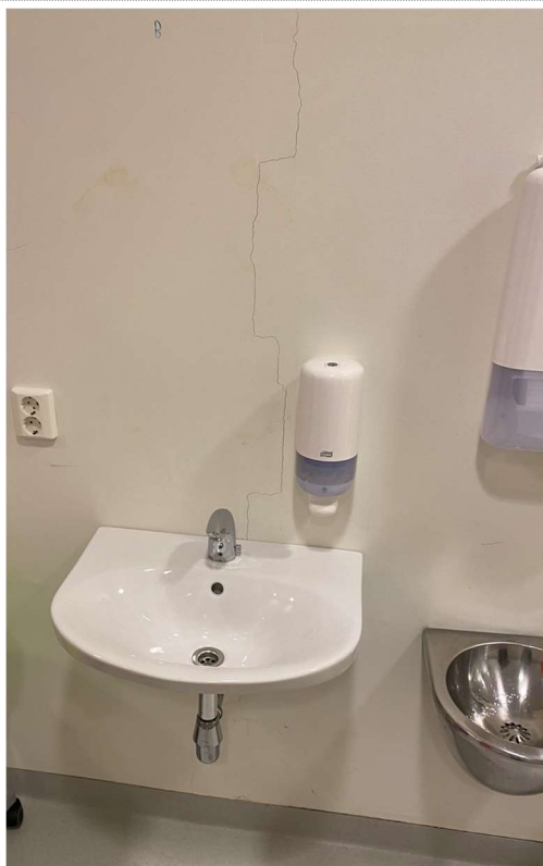
24 Innervegger. Eksempler på sprekk og riss på innerveggene i bygget.
