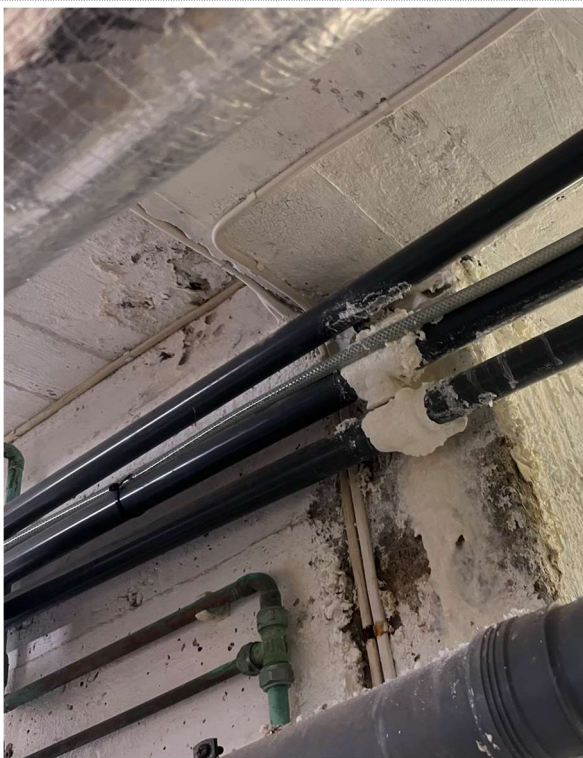
24 Innervegger. Skader på veggene til bassengrommet.
