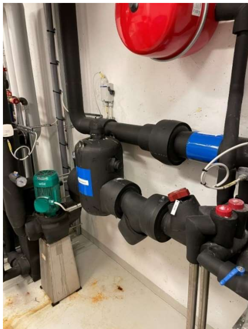
35 Varmepumpe- og kuldeinstallasjoner. Kartlegg eventuelle lekkasjer for varmepumpe.
