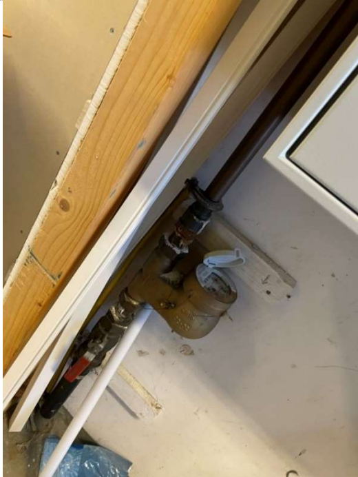
31 Sanitæranlegg. Stoppekran eiret.
