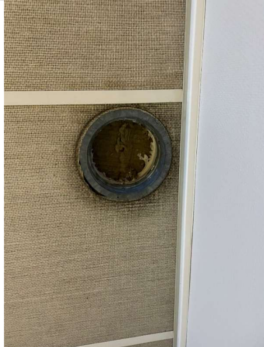
36 Luftbehandling. Mangler ventil.
