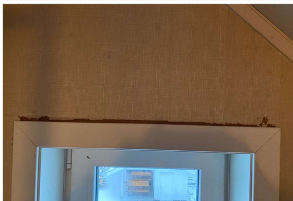
23 Yttervegger. Veggplatene innendørs er slitte og gamle, spesielt rundt vinduene.
