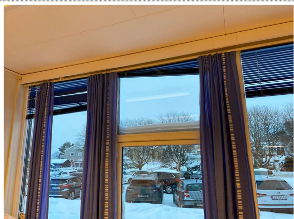
23 Yttervegger. Innvendige solavskjerminger.
