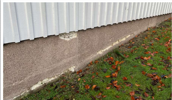
23 Yttervegger. Skader på grunnmuren på den gamle bygningen ved SFO.
