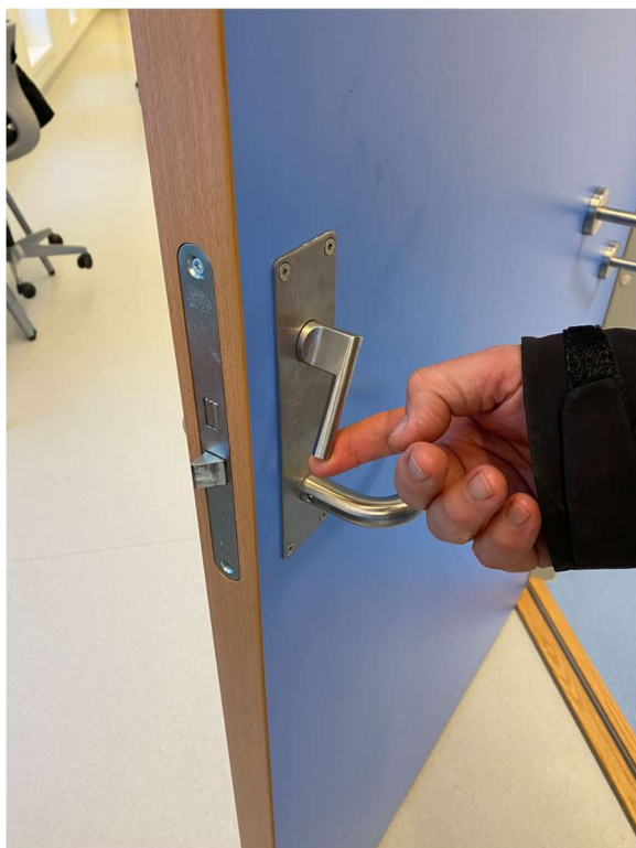
24 Innervegger. Feil beslag på låshåndtaket til HC-toalettet.
