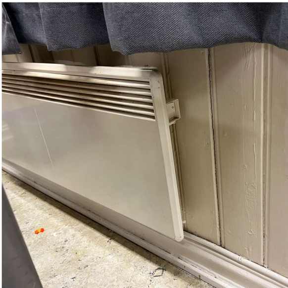
23 Yttervegger. Gammel og slitt inngangsdør.
