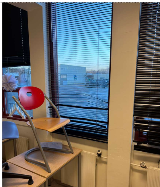
23 Yttervegger. Solavskjerming må byttes.
