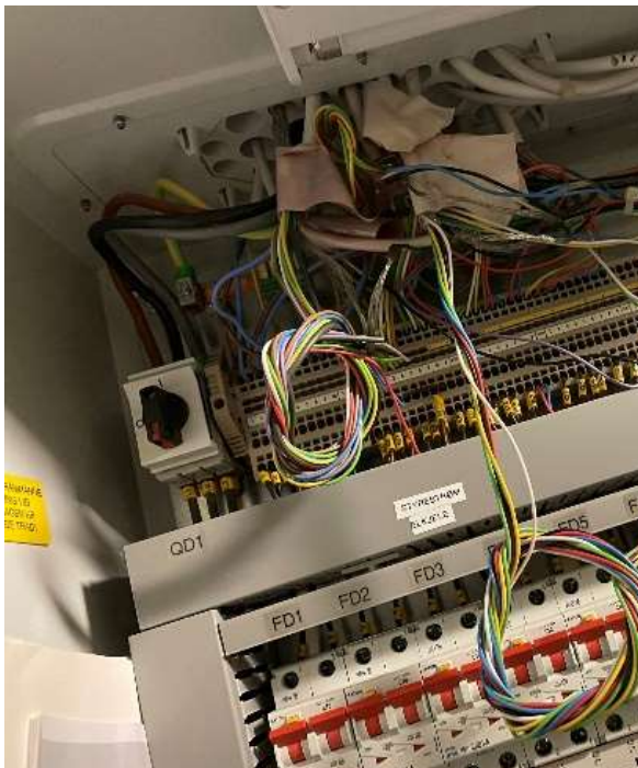
41 Basisinstallasjoner for elkraft. Løse ledninger og ikke merket i EL-skap.
