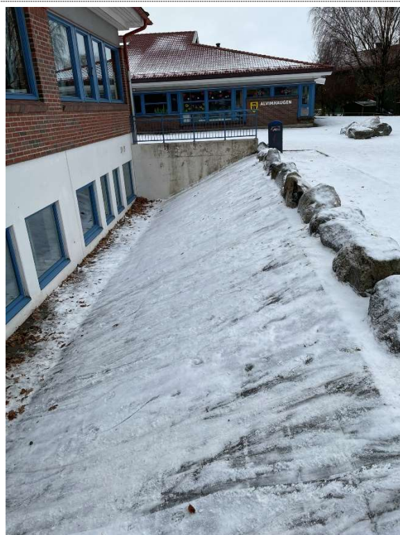
72 Utendørs konstruksjoner. Rømningsvei for bratt/glatt.
