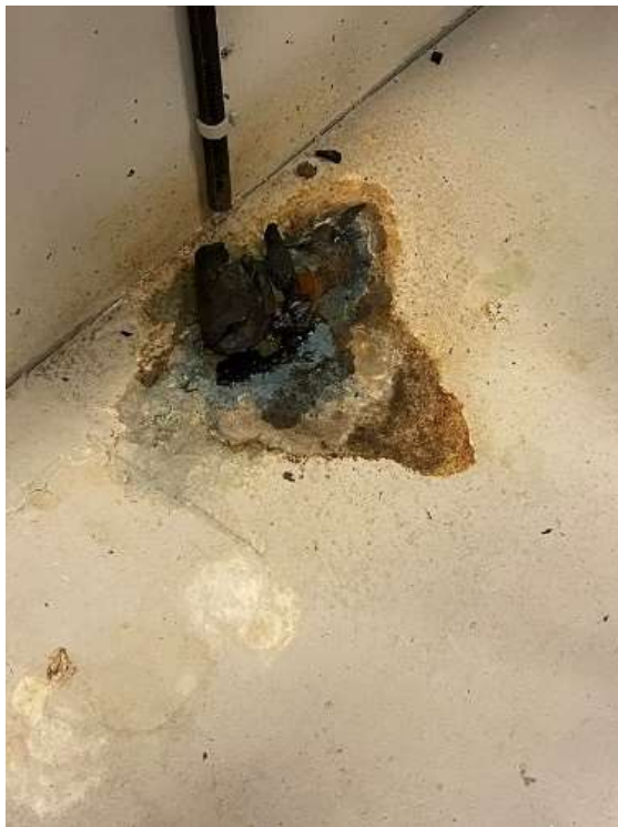
35 Varmepumpe- og kuldeinstallasjoner. Gulv under kran må rengjøres.
