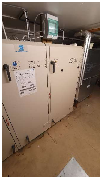
36 Luftbehandling. Et av skolens ventilasjonssystemer.
