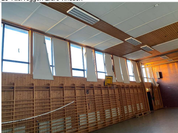
23 Yttervegger. Vinduene på gymsalen har dårlig solavskjerming og har overskredet levetid.
