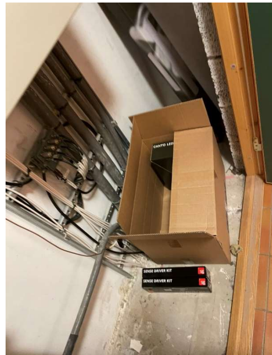
41 Basisinstallasjoner for elkraft. Fjern løse gjenstander i EL-skap. Brannfarlig.
