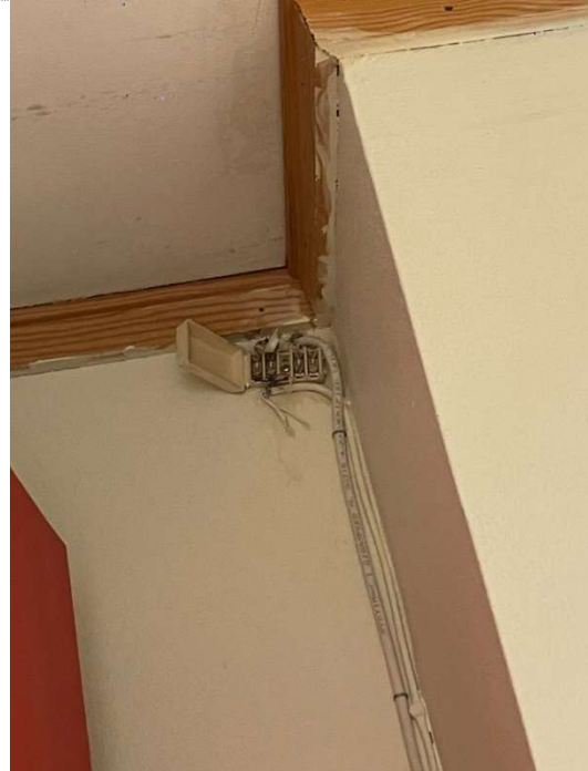
43 Lavspent forsyning. Ledning må fjernes.
