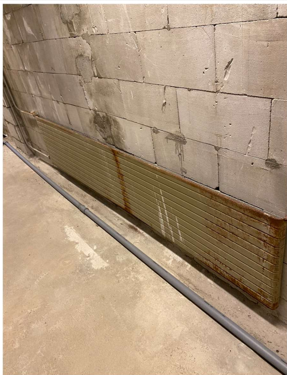
32 Varme. Radiatoren på teknisk rom i svømmehallen er dekket med noe rust.
