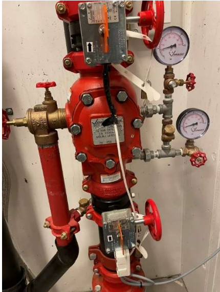
33 Brannsløkking. Sprinkelanlegg ikke iht. forskrift.
