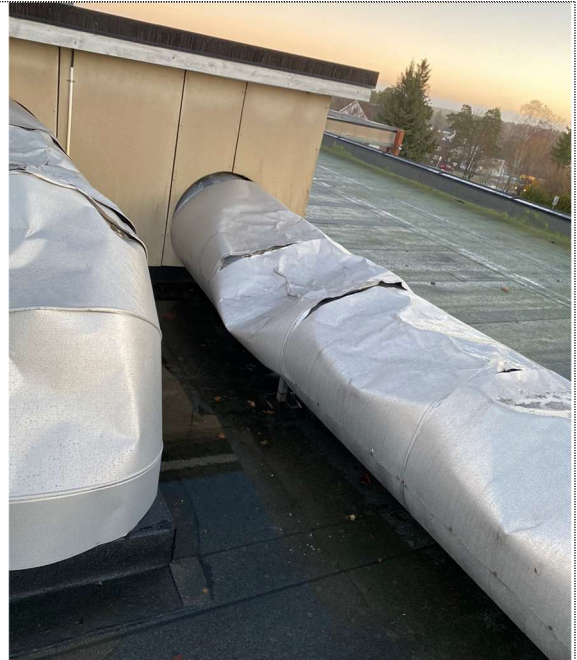
36 Luftbehandling. Skadet ventilasjonsrør.
