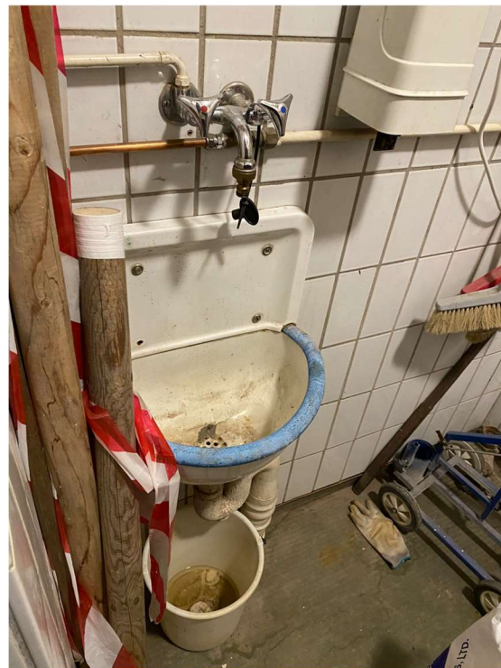
31 Sanitær. Rør under vasken i det ene bøttekottet fått noen lekkasjer.
