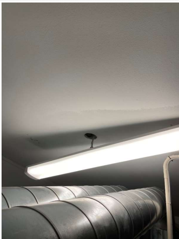
44 Belysning. Lampe må fastmonteres ordentlig i taket.
