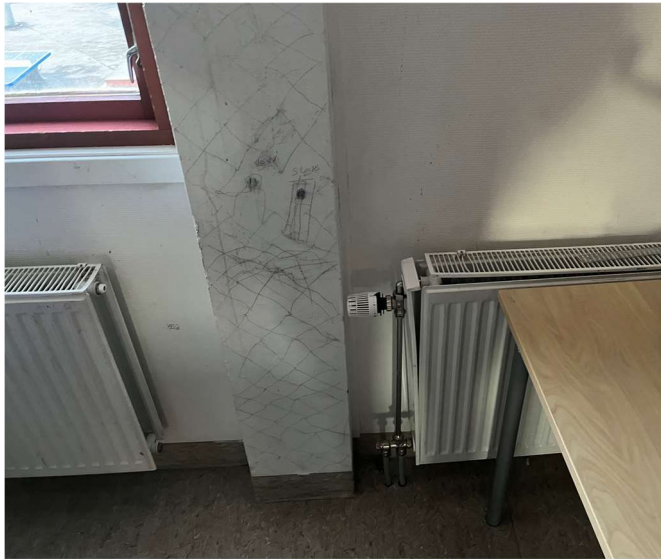
32 Varmer. Skadet radiatorer.
