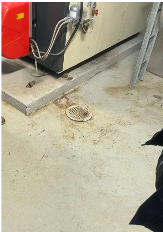
73 Utendørs røranlegg. Tett slukk på tekniskrom forårsaket av overvann.
