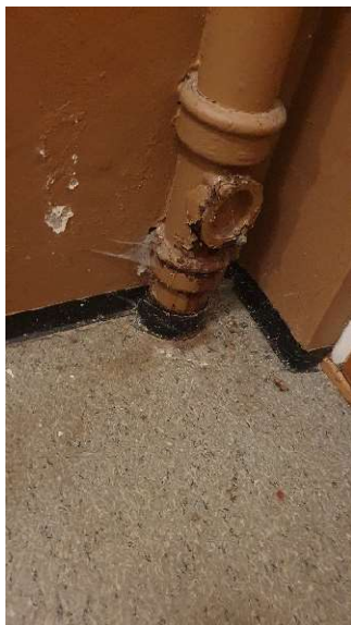
31 Sanitæranlegg, rør i korridor i kjeller
