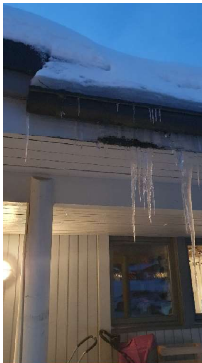
26 Yttertak. Istapper ved inngang
