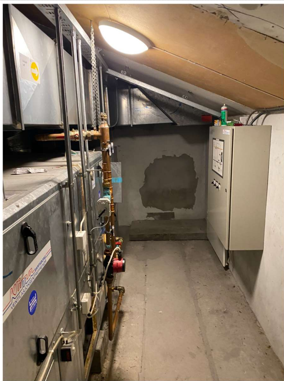
36 Luftbehandling. Ventilasjonsanlegg på gymsal.
