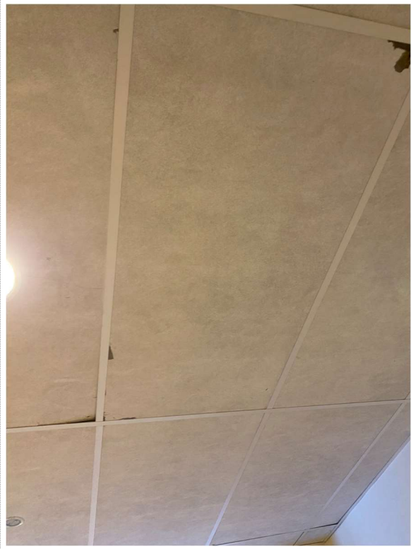
26 Yttertak. Gammel og slitt himlingsplate.
