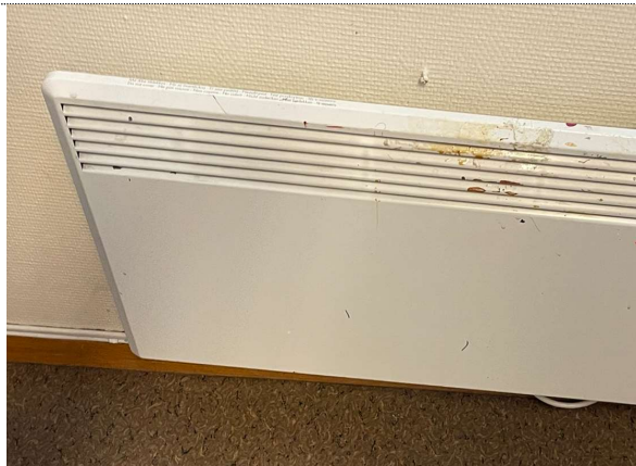
45 Elvarme. Slitt panelovn.
