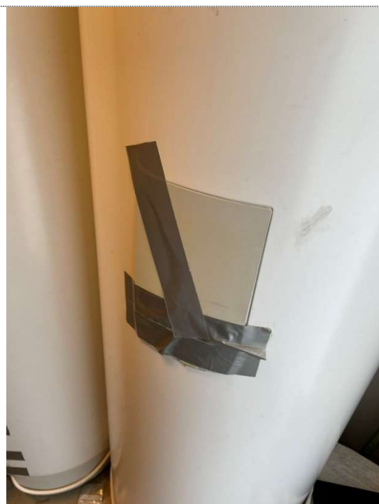
31 Sanitæranlegg. Lekk må erstattes på vannbereder.
