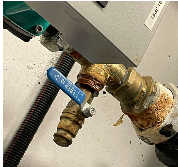
35 Varmepumpe- og kuldeinstallasjoner. Kran med utslag på overflater.
