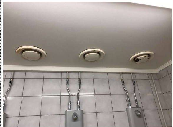
36 Luftbehandling. Gammel og slitt ventilasjonsluke på guttegarderoben.
