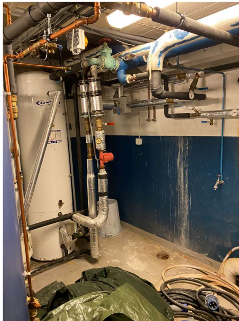
32 Varme. Teknisk rom i kjelleren på bygg A.
