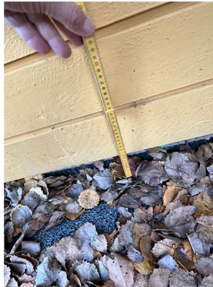
23 Yttervegger. Blader og løv nær trepanel.
