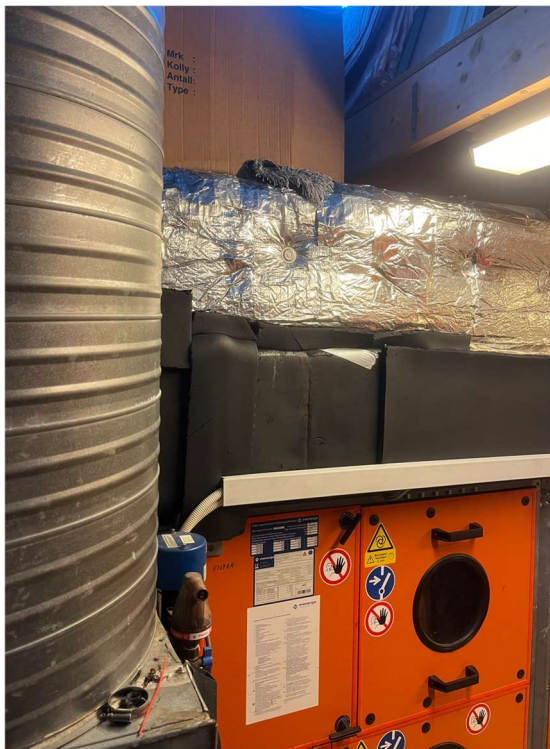
36 Luftbehandling. Ventilasjonssystemet for bassenget.
