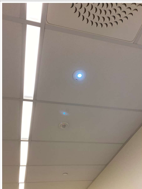
44 Lys. Eksempel på at nødlys er på i bygget.
