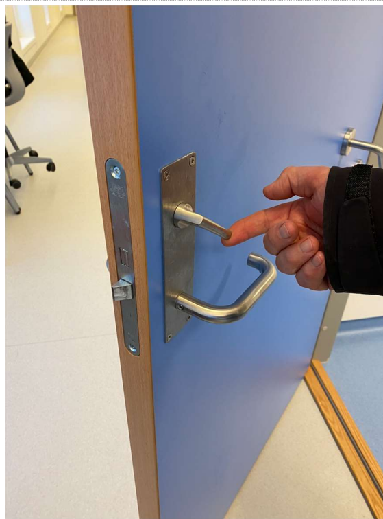
24 Innervegger. Feil beslag på låshåndtaket til HC-toalettet.
