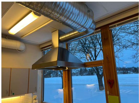
36 Luftbehandling. Avtrekksluftkanal til kjøkkenet.
