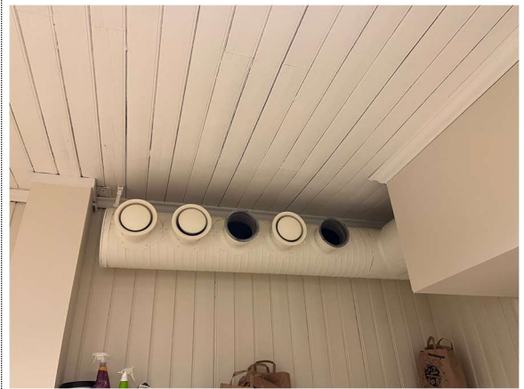
36 Luftbehandling. Mangler ventilasjonsluker.
