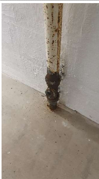
31 Sanitæranlegg, rør ved svømmehall
