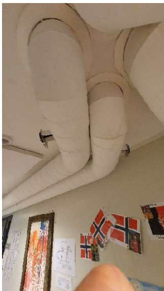
36 Luftbehandling. Tidligere vannlekkasje som ikke er utbedret.
