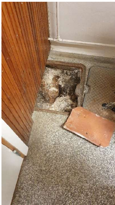
31 Sanitær. Tette bunnledninger.
