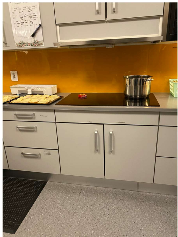
36 Luftbehandling. Avtrekksluftkanal på kjøkkenet.
