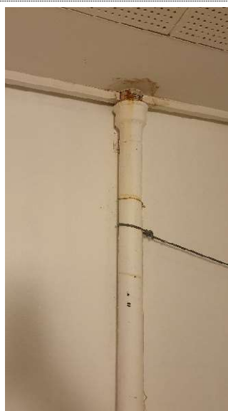
31 Sanitæranlegg, rør i kjeller
