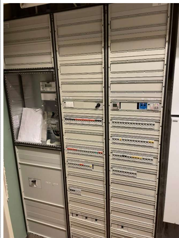
41 Basisinstallasjoner for elkraft. Fjern brennbart materiale i EL-skap.
