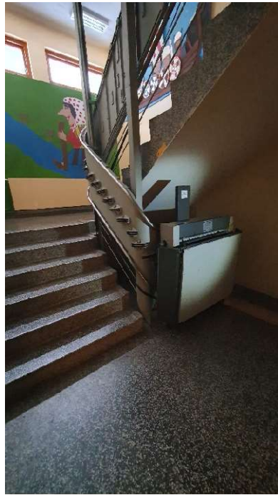
62 Persontransport. Trappeheis ute av drift. Fjernes.
