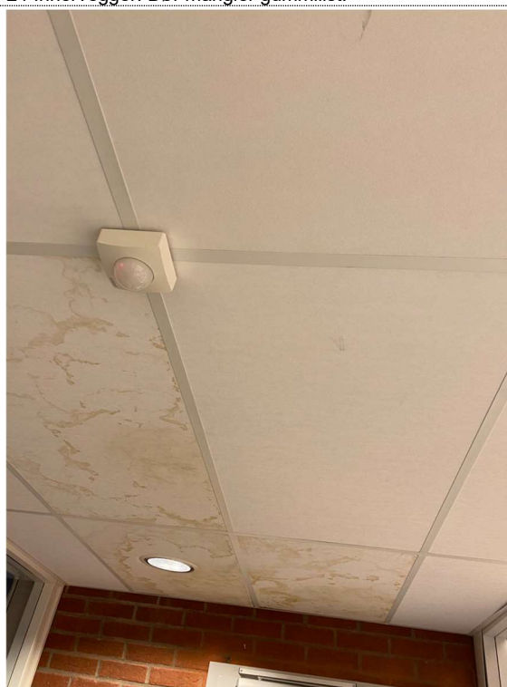
26 Yttertak. Skadet himling på grunn av lekkasjer.
