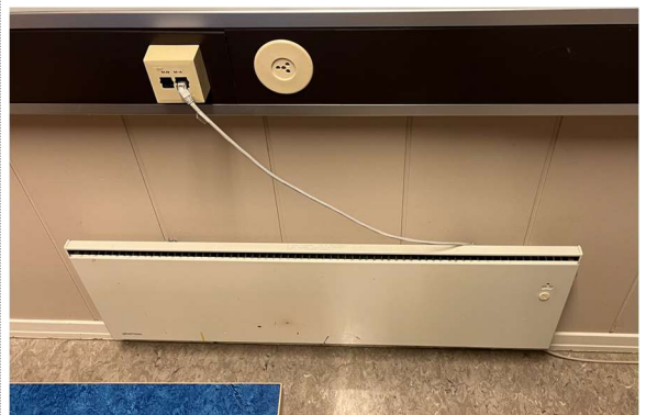
52 Integrert kommunikasjon. Internettkabelen kommer i kontakt med elvevarmen, noe som utgjør en brannfare.
