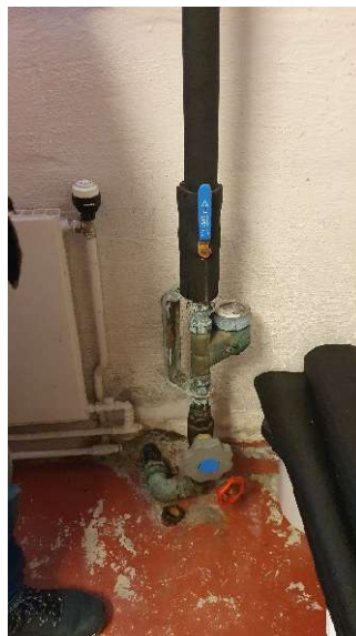
31 Sanitær. Stoppekran merkes
