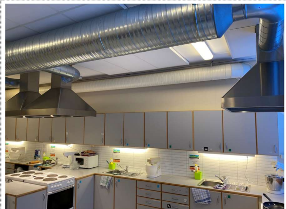
36 Luftbehandling. Avtrekksluftkanal til kjøkkenet.
