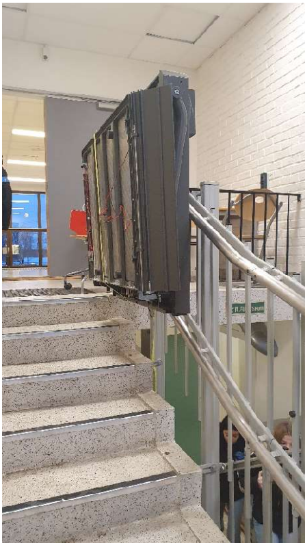
62 Persontransport. Trappeheis delvis ut av funksjon
