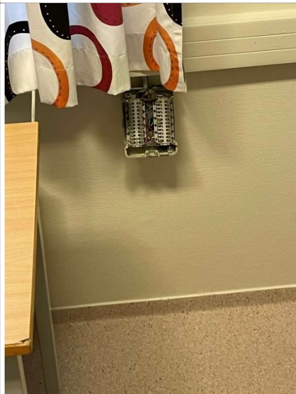
43 Lavspent forsyning. Mangler deksel på stikkontakt i klasserom.
