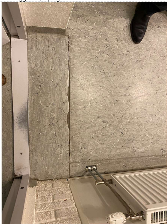
25 Dekker. Slitte gulvoverflater.
