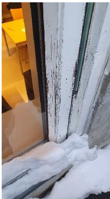
23 Vinduskarm med flassende overflater. Kjellervindu.
