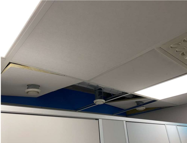
26 Yttertak. Skadet himling.
