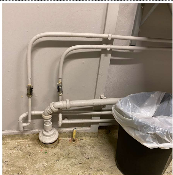
31 Sanitær. Rør må byttes før det oppstår lekkasjer.
