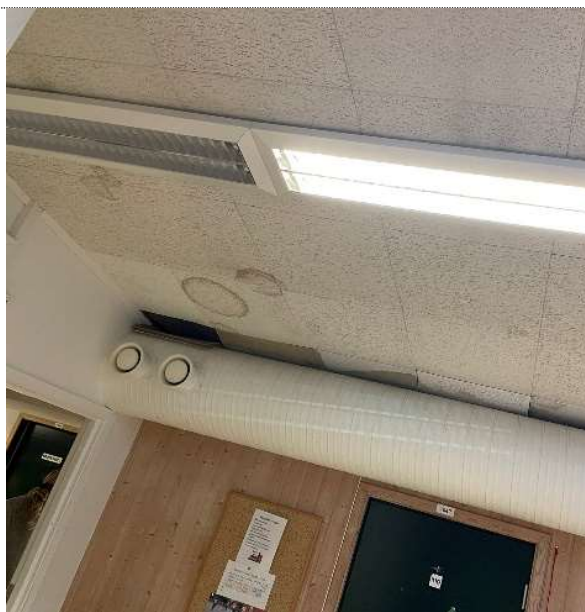
25 Dekker. Vann/fuktskade på himling. Bytt ut himling.
