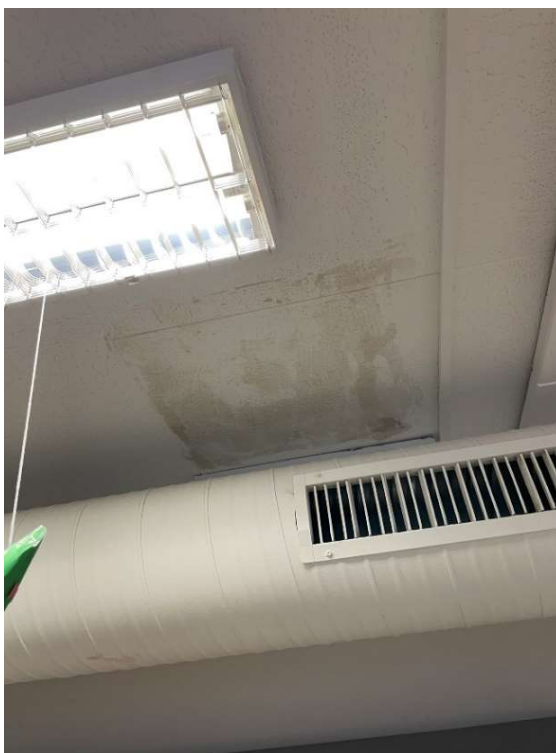
25 Dekker. Bytt ut himlingsplate etter vannskade.
