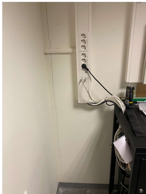
24 Innervegger. Eksempler på sprekk og riss på innerveggene i bygget.
