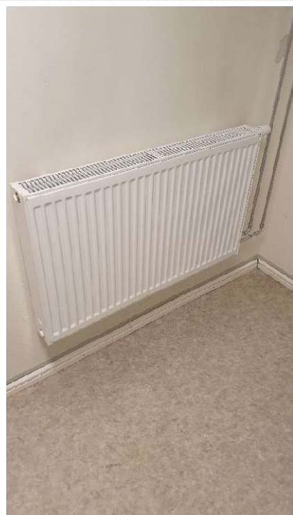
32 Varmeanlegg. Nyere radiatorer.
