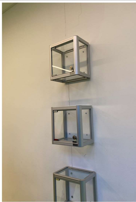
24 Innervegger. Eksempler på sprekk og riss på innerveggene i bygget.
