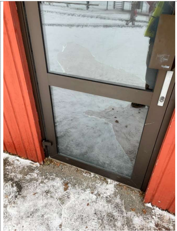
23 Yttervegger. Dårlig og ødelagt solfilm på dør.
