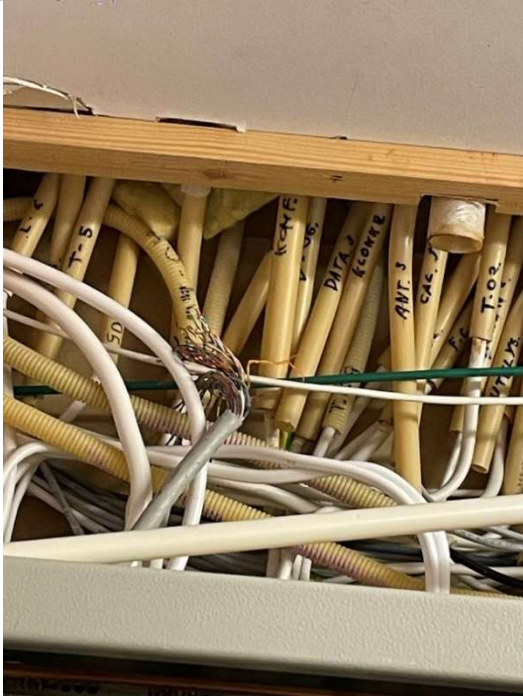
43 Lavspent forsyning. Løse ledninger i EL-skap.
