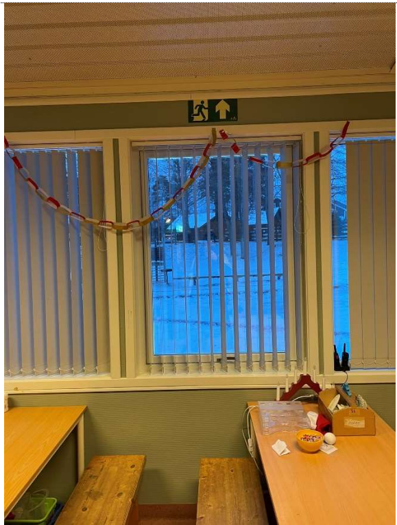
23 Yttervegger. Bord hindrer rømningsvei.
