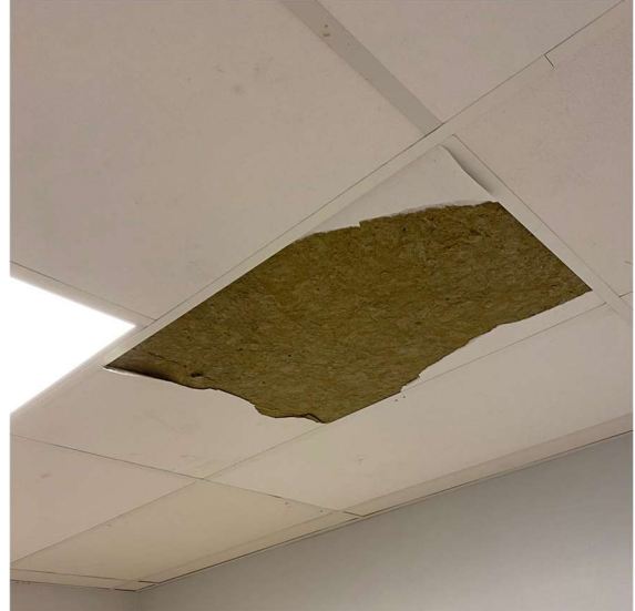
26 Yttertak. Skadet himling.
