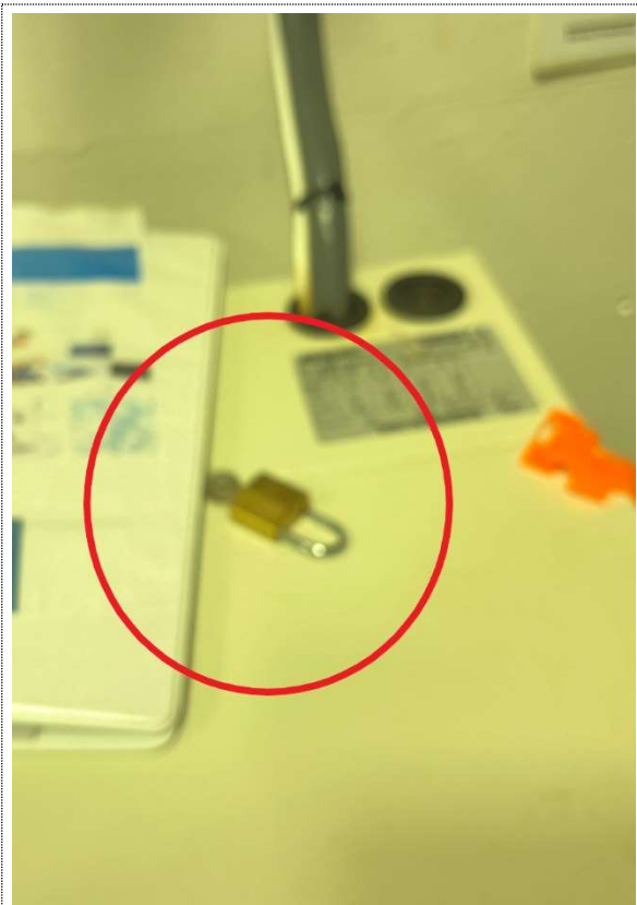
33 Brannslukking. Låsen til kjettingen for sprinkleranlegget..
