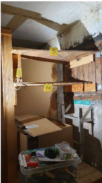
23 Yttervegg. Rømningsvei som ikke er iht. forskrift og med vanninntrengning.
