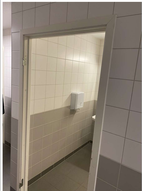
24 Innervegger. HC toalettet mangler dør.
