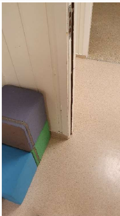
24 Innevegger. Overflater er slitte.
