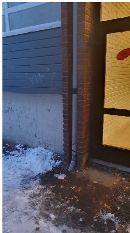
23 Yttervegger. Utside av der vann kan trenge inn under trapp.
