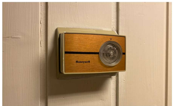
36 Luftbehandling. Gammel ventilasjonstemperaturstyring.
