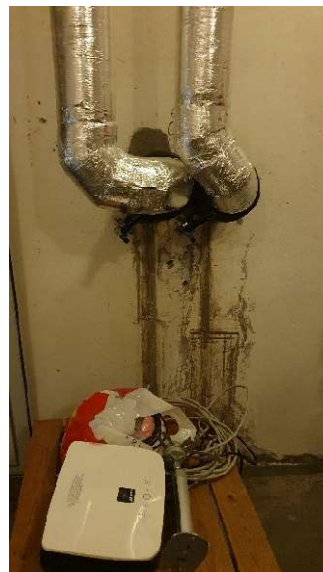
23 Yttervegg i kjeller ved serverskap.
