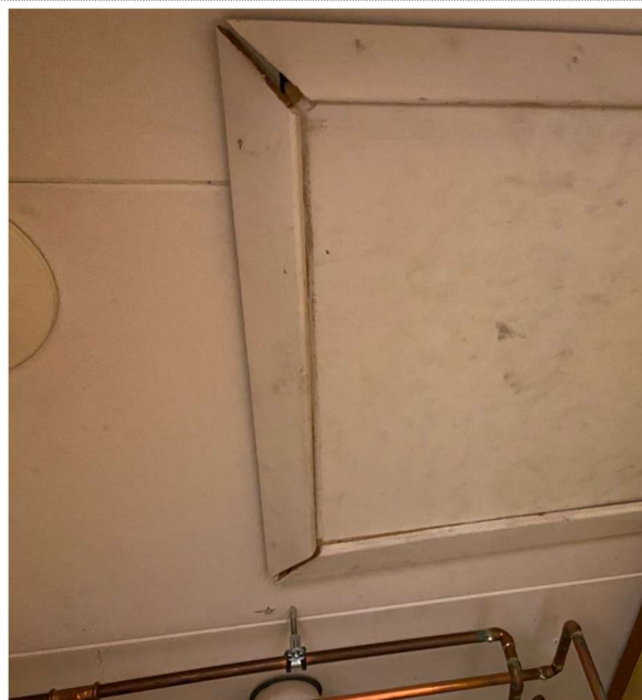
25 Dekker. Skadet og gammel takluke.
