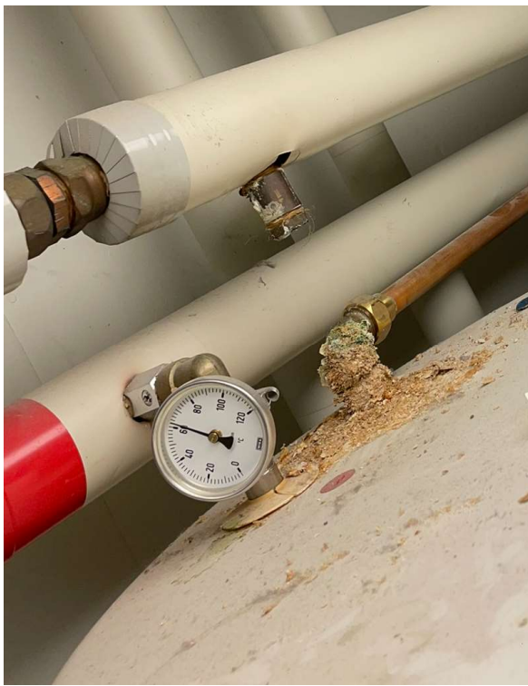
32 Varme. Beholder må byttes.
