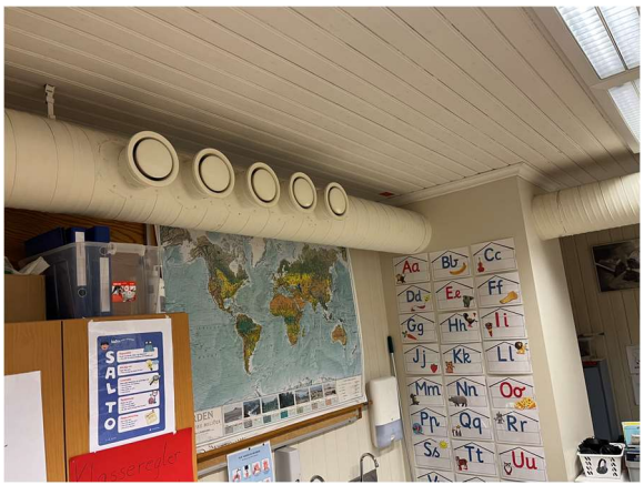
36 Luftbehandling. Eksempel på et av klasserommene i 1. etasje som har dårlig lufting.
