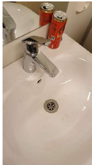
31 Sanitær. Vannkran i damegarderobe mangler vann.
