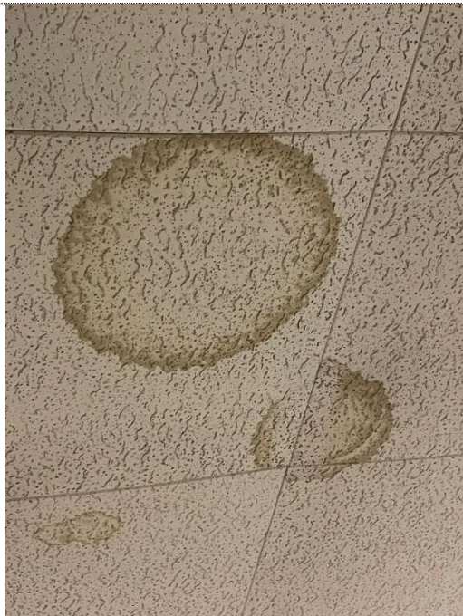
25 Dekker. Vann/fuktskade på himling. Bytt ut himling.
