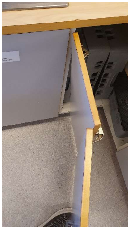
27 Fast inventar. Løse kjøkkenskap på skolekjøkken.
