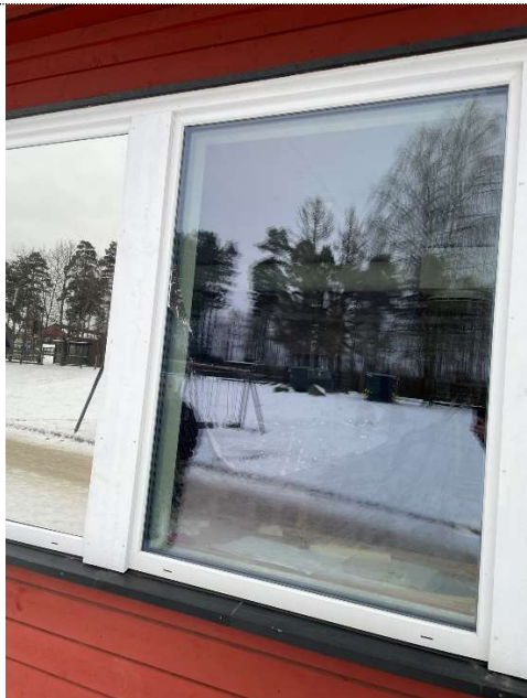
23 Yttervegger. Dårlig og ødelagt solfilm på vindu.
