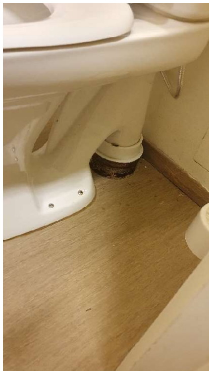
31 Sanitær. Vannlekkasje fra pakning, senest høst 2023.
