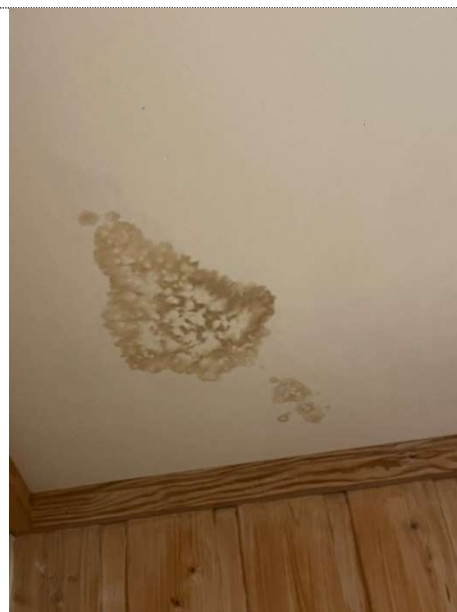
25 Dekker. Vann/fuktskade på himling. Bytt ut himling.
