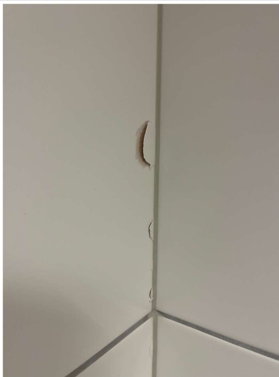
24 Innervegger. Skade på veggen på HC-toalettet ved siden av garderoben.
