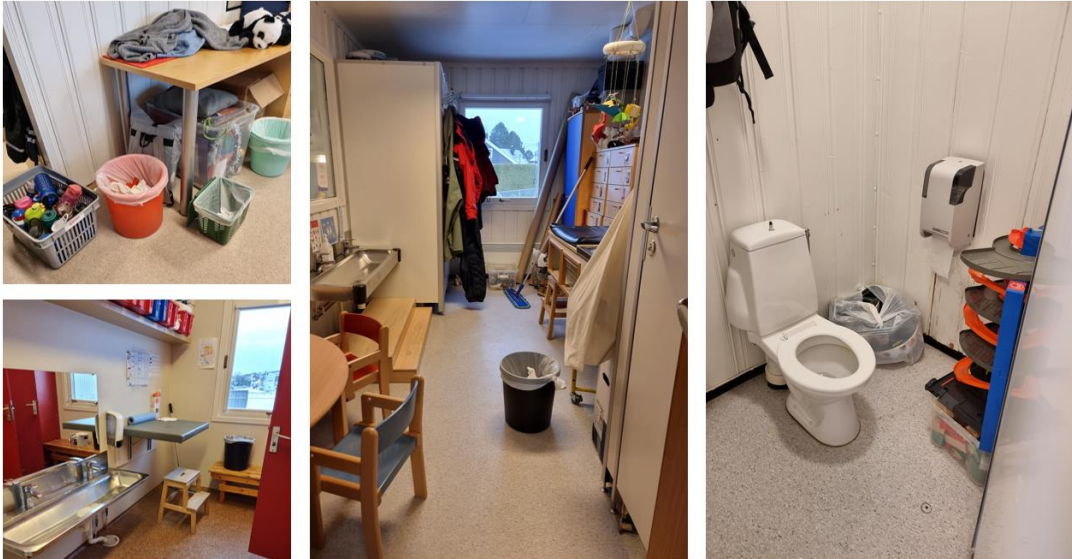
Figur 50 Bildene viser funksjonelle mangler i toaletter og stellerom som medfører dårlige hygieniske og ergonomiske forhold. Rommene benyttes også til oppbevaring av forskjellig utstyr på grunn av areal og funksjonsmangler.
