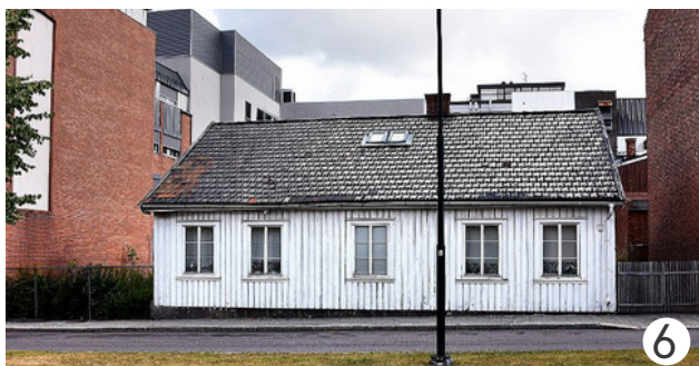
Korsgata 3, 1867 - bygget er i relativ dårlig forfatning og må renoveres - ikke i bruk.
